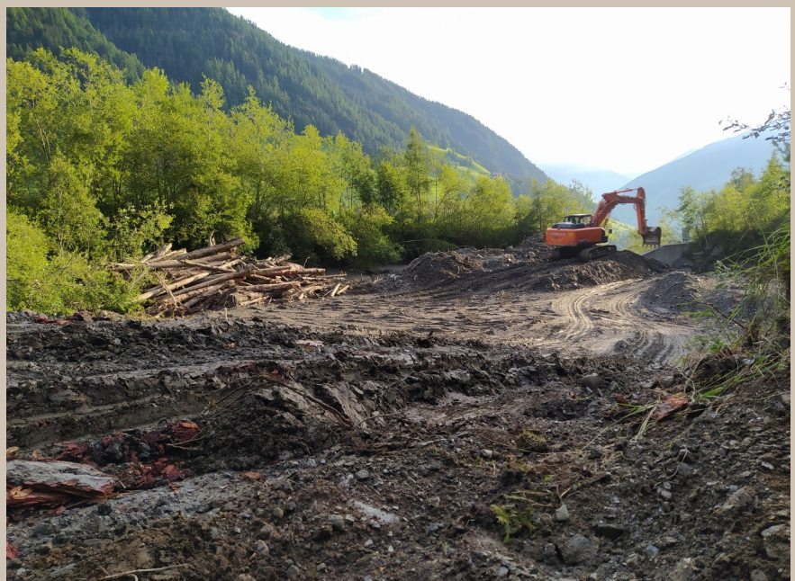
Der Damm in der Derfl-Kahle hat ein Übermuren der Felder verhindert. Nun müssen die Erdmassen wieder abtransportiert werden.
